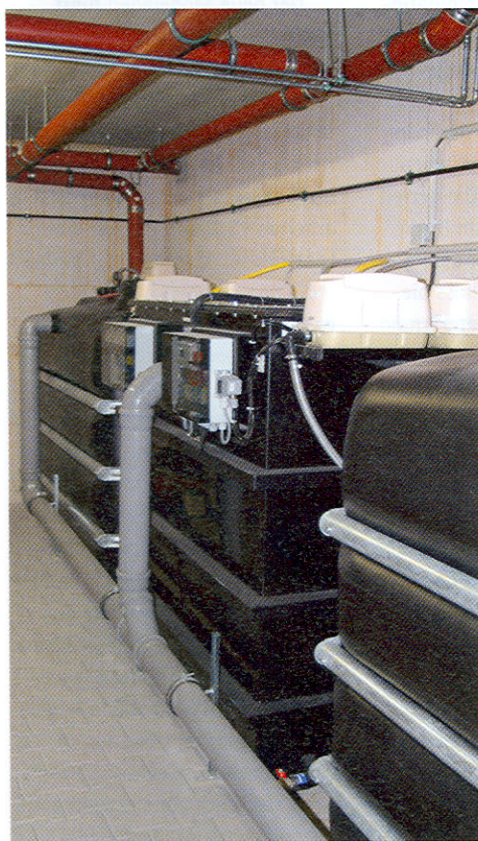
Diese Maschine der GEP Umwelttechnik GmbH recycelt das Grauwasser aus 90 Mannheimer Studentenwohnungen.
