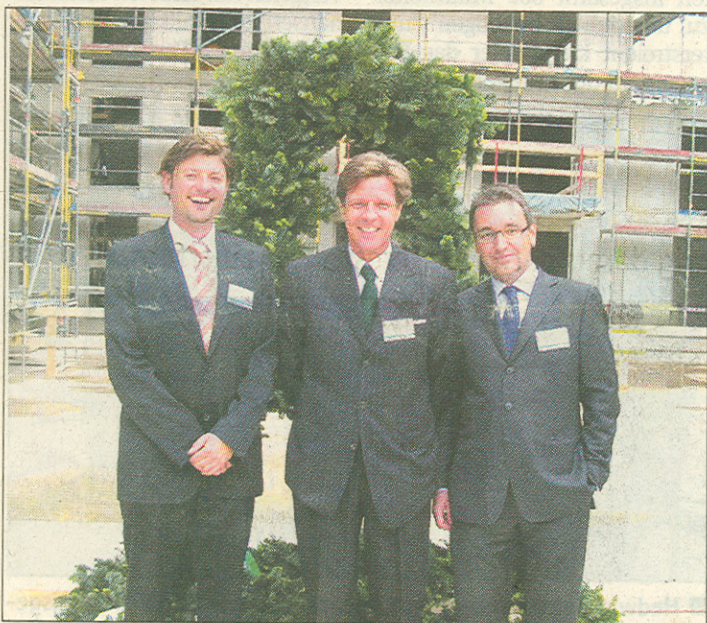
■ Richtfest der „Clarenbachgärten“, einem exklusiven Wohnungsbauprojekt der Fay-Gruppe in der Herbert-Lewin-Straße. Von links nach rechts: Ausführender Architekt Claus Fischer, Vorstandsvorsitzender Professor Andreas-Norbert Fay und Geschäftsführer Günter Berlo. (Foto: Reuß)
